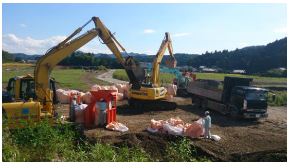
写4 平成27年関東・東北豪雨時災害基地
